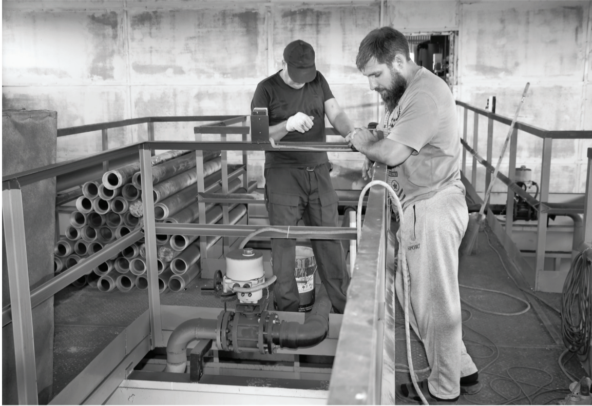
Специалисты осуществляют проверку оборудования.
