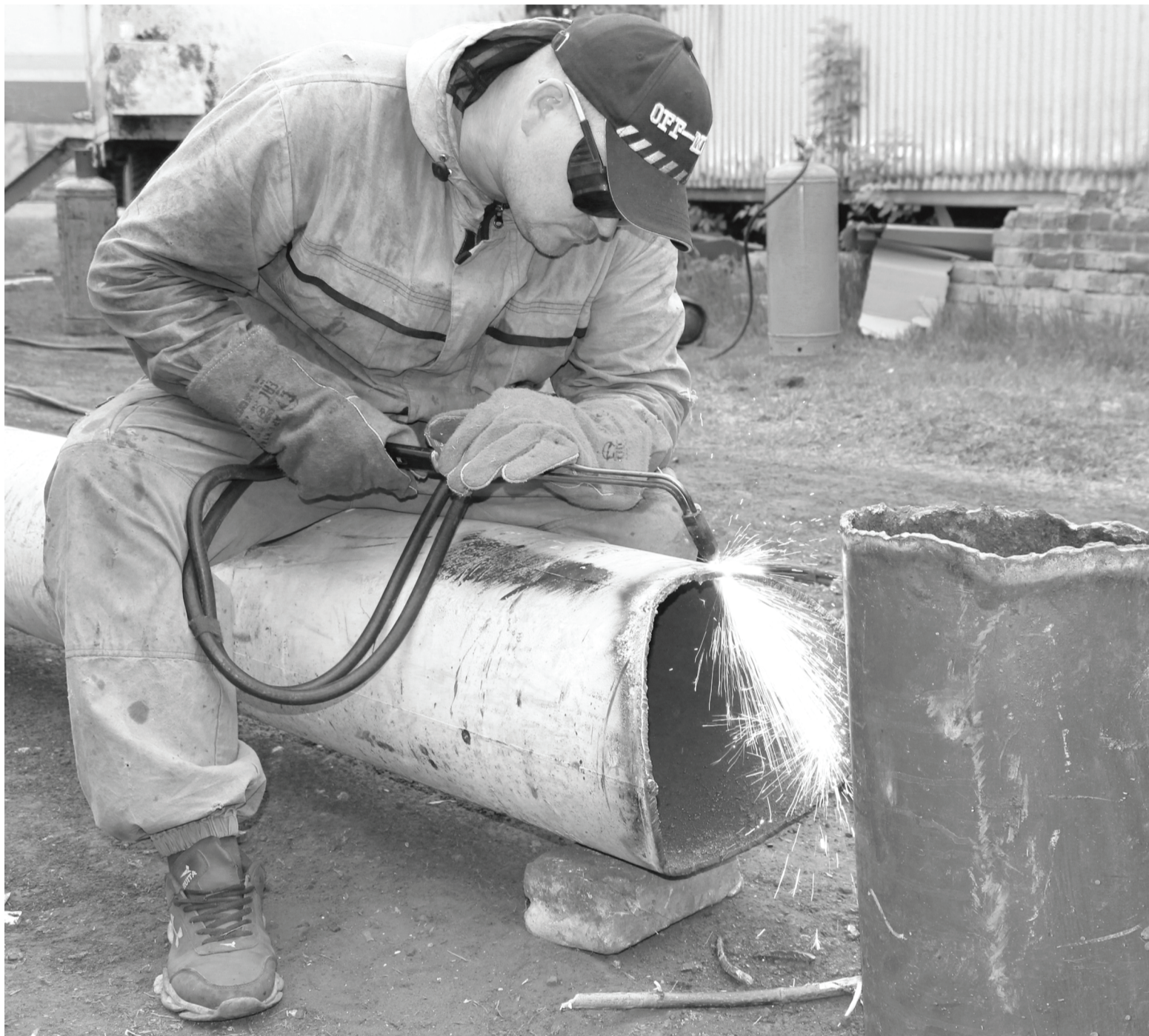
Сотрудники подрядной организации ООО «Никос» знают своё дело. Кроме того, в проведении капитального ремонта котельной Сладковской районной больницы помощь оказывают и специалисты МУП ЖКХ.
